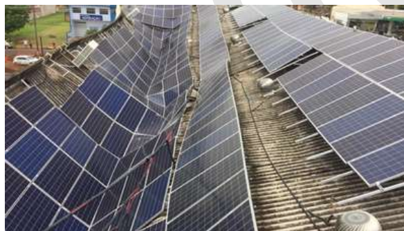
Painel solar convencional
